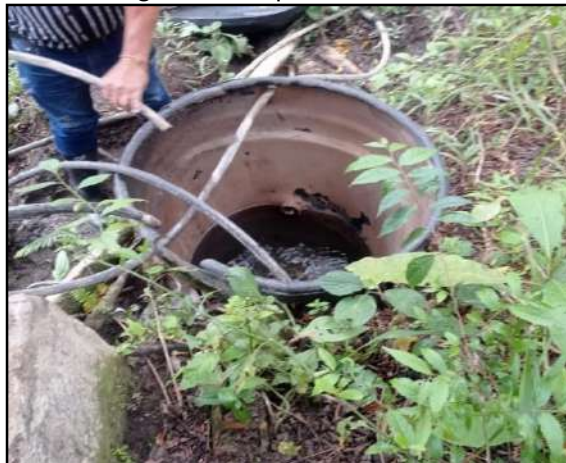
Imagen 4. Tanque de distribución
