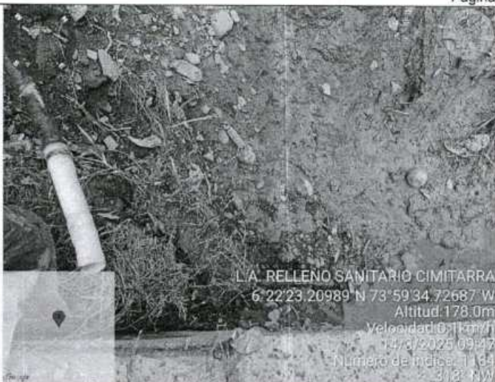
Fotografía 14. Fuga de lixiviados directamente al suelo del relleno sanitario La Florida.
