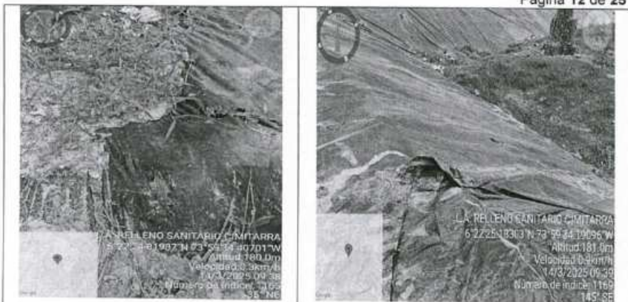
Fotografía 9, 10, 11 y 12. Daños en la geomembrana de la celda cuatro (4) del relleno sanitario La Florida.
